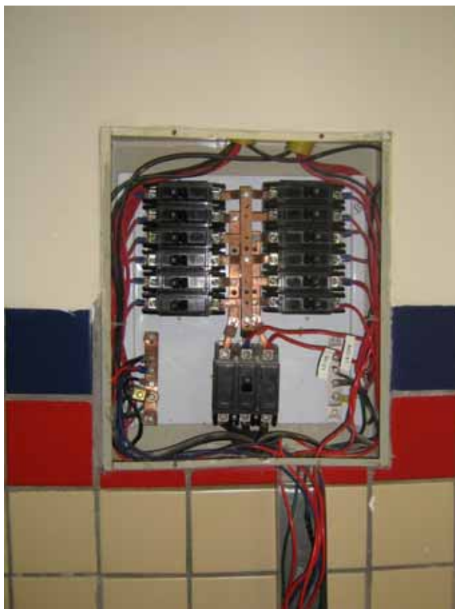
Figura 3-24: Quadro de Energia da sala de Informática Escola Prof. Leal de Barros.
