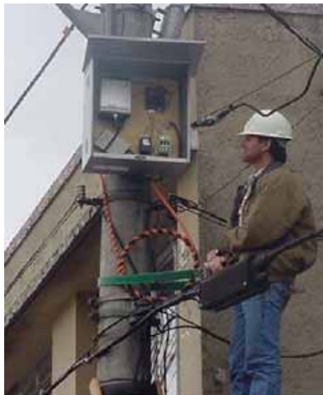
Figura 3-3: Instalação de um Master no Paraná feita pela Copel.
