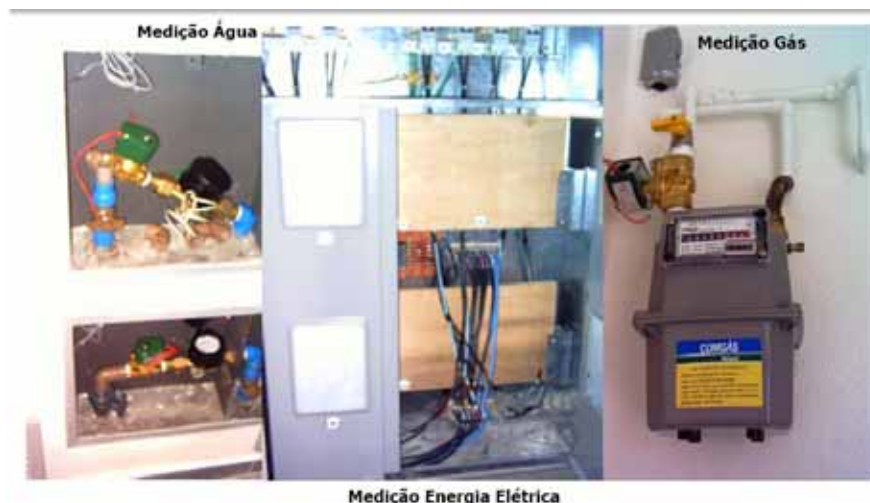
Figura 2-2: Equipamentos de medições em Narrowband PLC.
