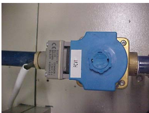
Figura A.6 Válvula de Controle (0-100%) do sistema de bombeamento do LAMOTRIZ.
