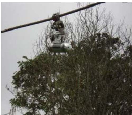
Figura 2.5 – Emissor a laser do sistema VFlecha instalado em uma LT [32].
