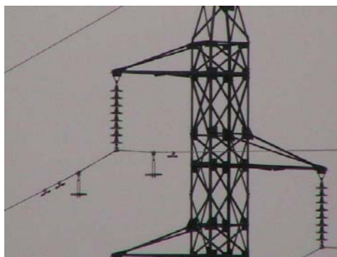
Figura 3.3 – Fotografia do arranjo de pesos adicionais aplicados a uma linha de 138 kV para reduzir os ângulos de balanço após substituição do condutor CAA Partridge 266,8 MCM pelo condutor CAL Butte 321,8 MCM de peso inferior [47].
