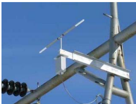
Figura 2.7 – Sensor ThermalRate instalado em uma estrutura de fim de linha [39].
