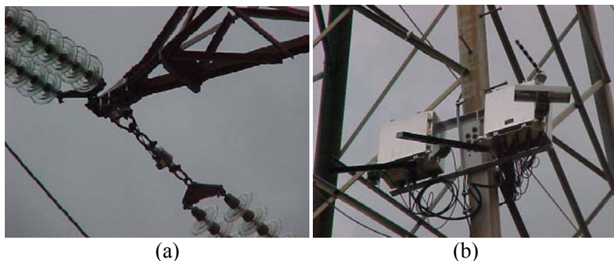
Figura 2.3 – Sistema CAT-1: (a) célula de carga entre a torre e a cadeia de isoladores e (b) painéis solares que alimentam as baterias recarregáveis do sistema [28].
