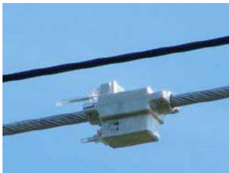
Figura 2.8 – Instalação do Ampacimon em uma linha de 400 kV [42].
