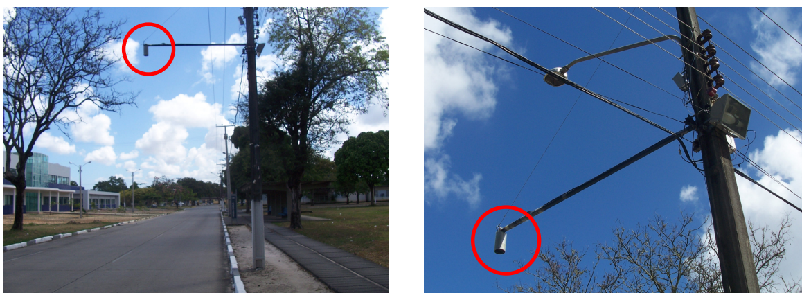
Figura 5.1. Equipamento óptico (detalhe circular) instalado em um poste de iluminação pública.
