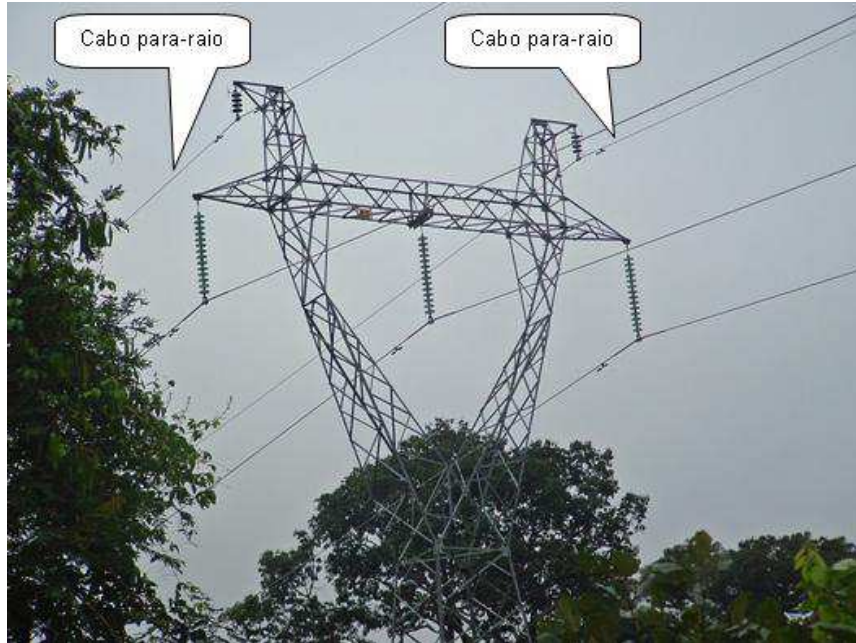
Figura 20 – Torre de linha de transmissão e a localização dos cabos para-raios.
