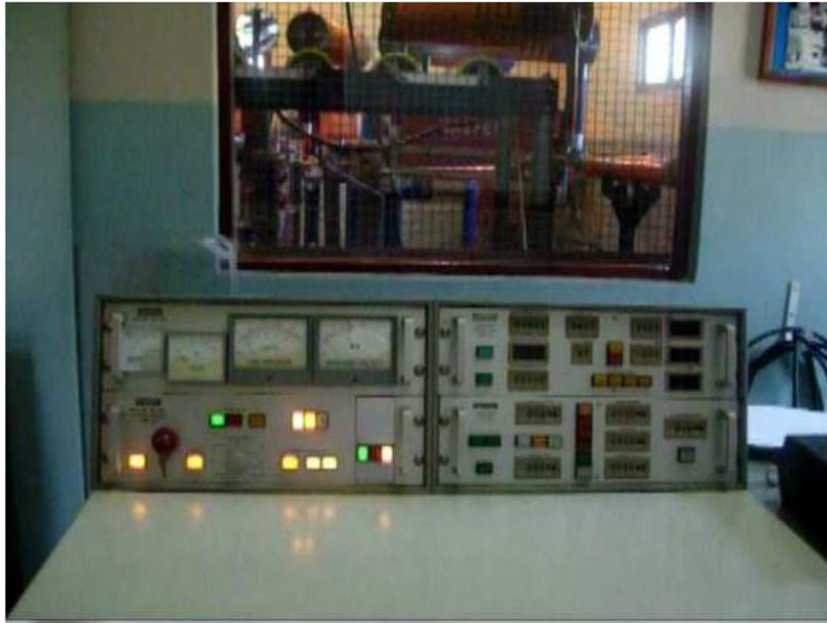
Figura 30 – Painel de controle do gerador.
