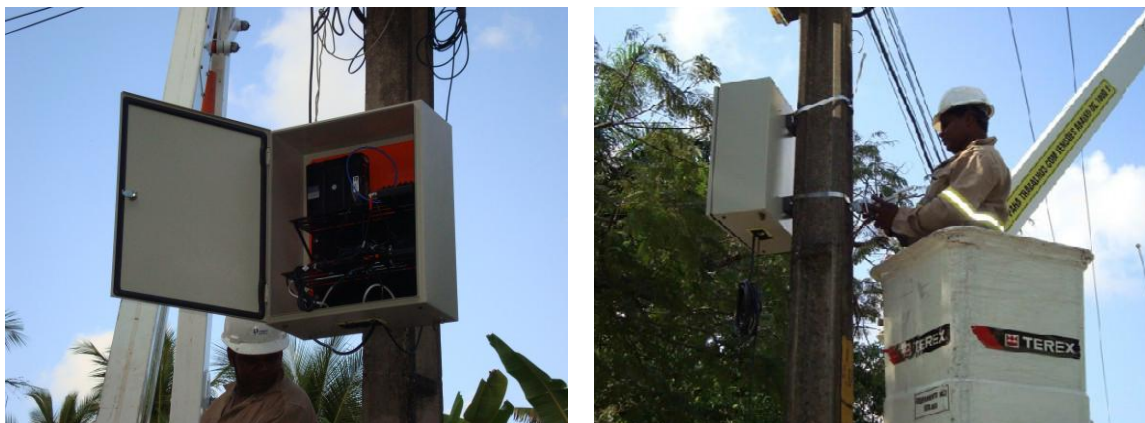
Fig. 56 – Instalação das caixas com Thin Clients no campus da UFPE.
