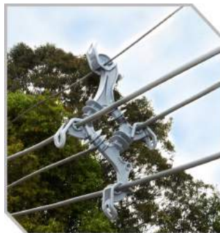
Figura 2 – Conjunto com cabo mensageiro, espaçador e cabos de força .
