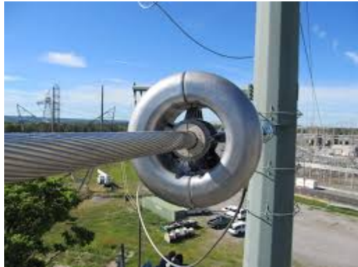
Figura 19 – Equipamento Power Donuts em uma estrutura metálica
