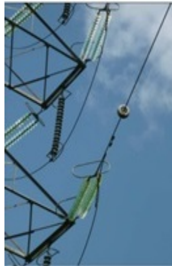
Figura 18 – Equipamento Power Donuts em uma estrutura metálica
