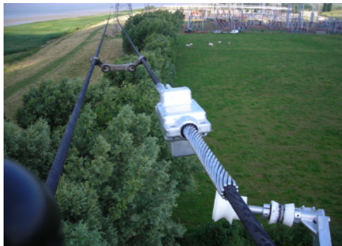
Figura 28 – Foto em detalhe do aparelho Ampacimon no cabo condutor
