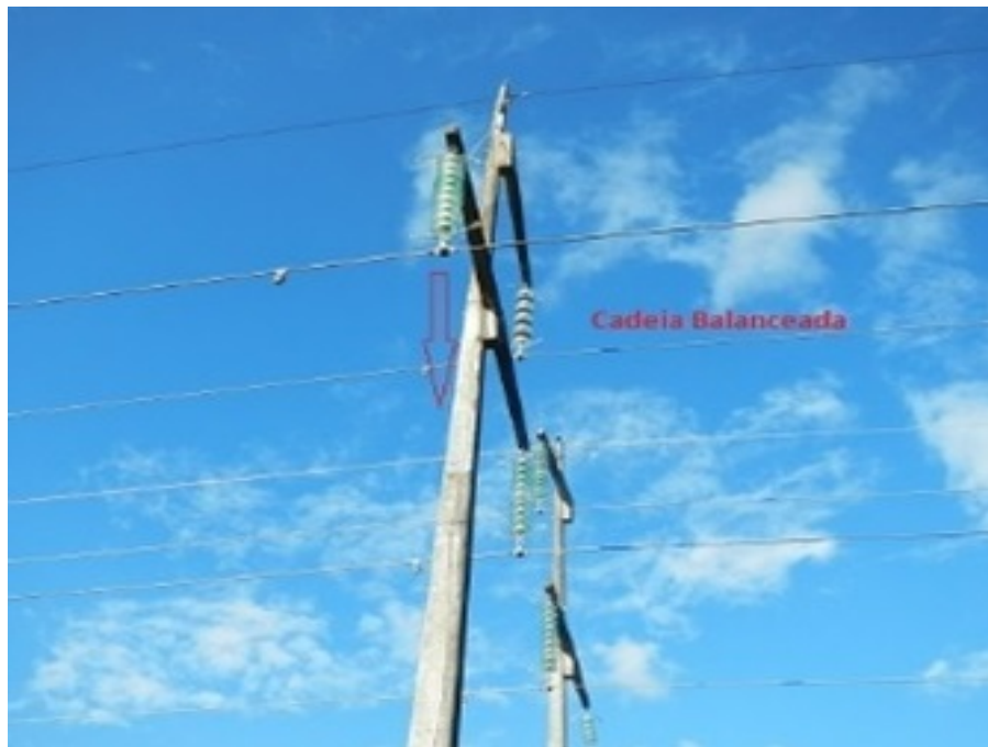
Figura 69 – Cadeia de suspensão na vertical, indicando balanceamento das trações horizontais dos vãos adjacentes a esta estrutura.
