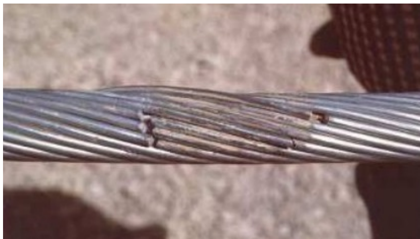
Figura 64 – Cabo condutor com tentos partidos
