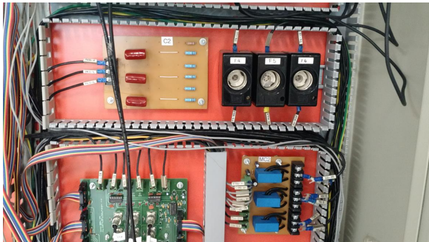
Figura 72 – Fusíveis de proteção, capacitores do filtro LC e placas de medição do Conversor do Lado da Máquina.
