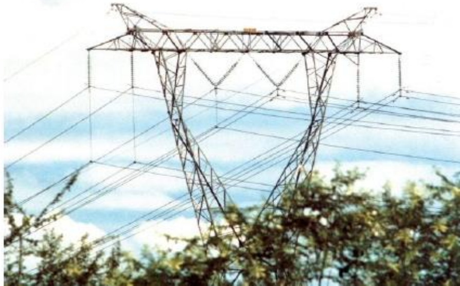
Figura 5 – Teste da Técnica de Feixe Expandido em linha 230 kV Paulo Afonso - Milagres
