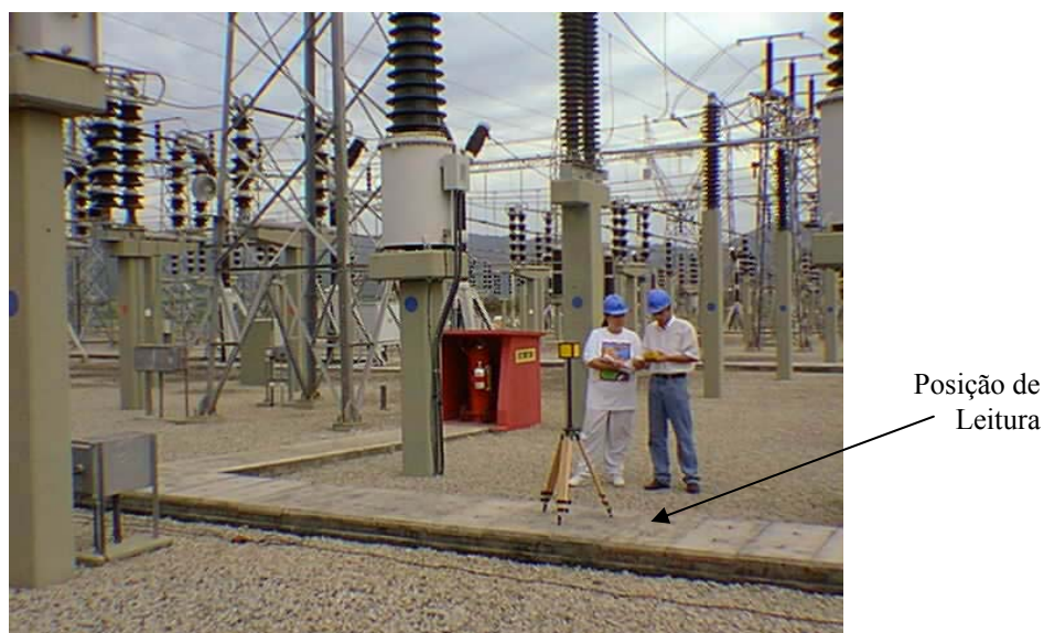
Figura 3.5: Corte transversal da subestação 230/138kV onde foram realizadas as medições de campos eletromagnéticos com os medidores unidirecional e isotrópico.
