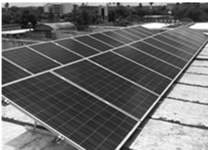
Figura 4.12 - Instalação sobre telhado da DMU-94
