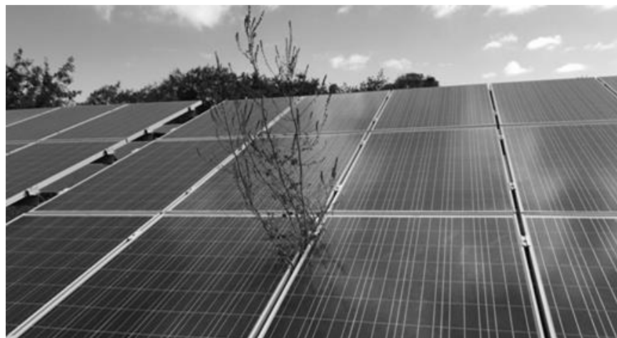
Figura 4.17 - Falta de controle da vegetação na DMU-3
