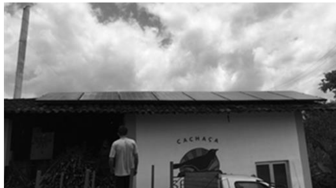
Figura 4.15 - Sujidade proveniente da fumaça da chaminé da cachaçaria.
