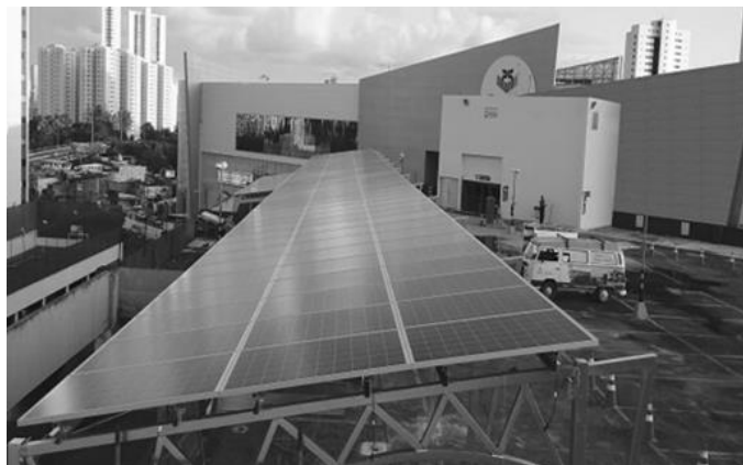
Figura 4.24 - Instalações da DMU-13 na cobertura de estacionamento.
