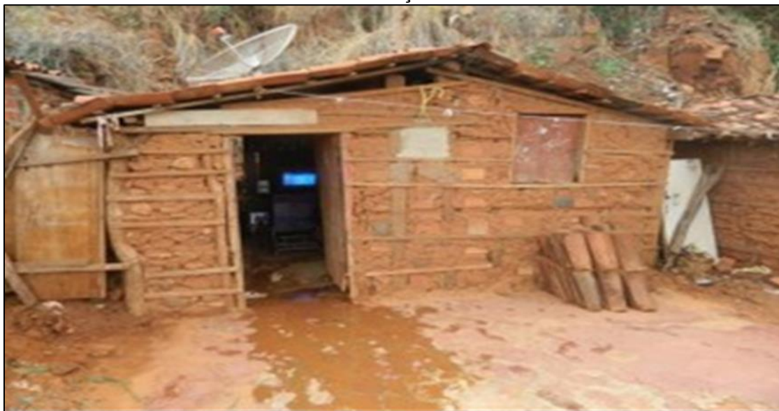
FIGURA 5 - CASA EM SITUAÇÃO DE RISCO - PICOS-PI
