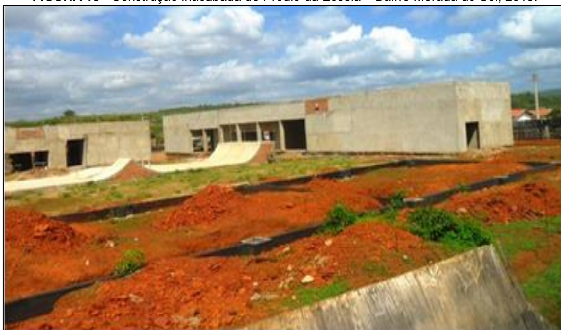
FIGURA 13 - Construção inacabada do Prédio da Escola – Bairro Morada do Sol, 2015.
