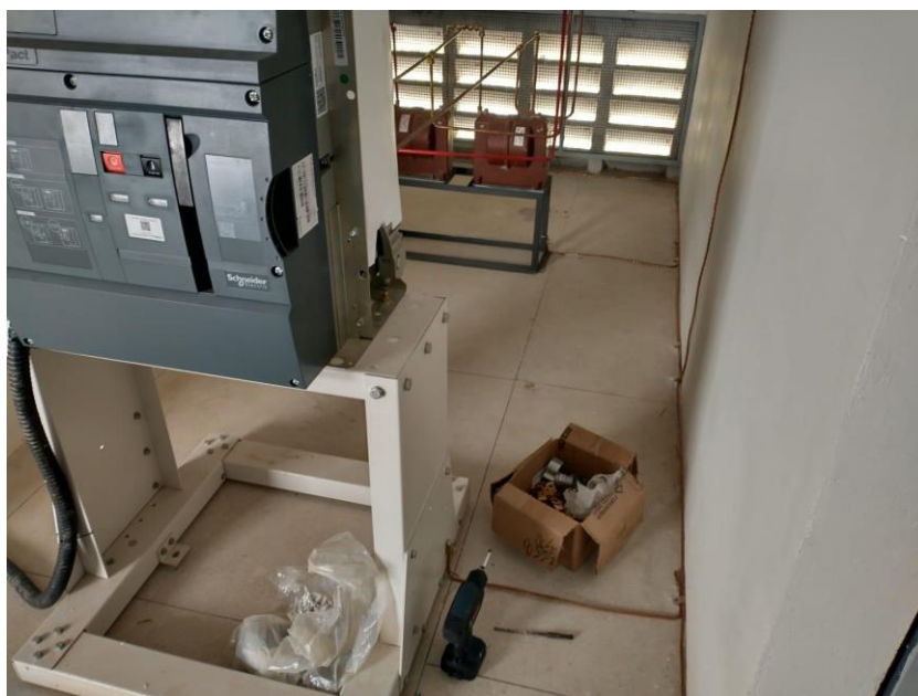
Vista do interior da subestação
